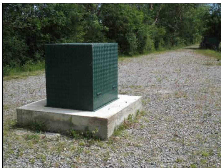
Forage Orist F6 : dalle et capot de protection
