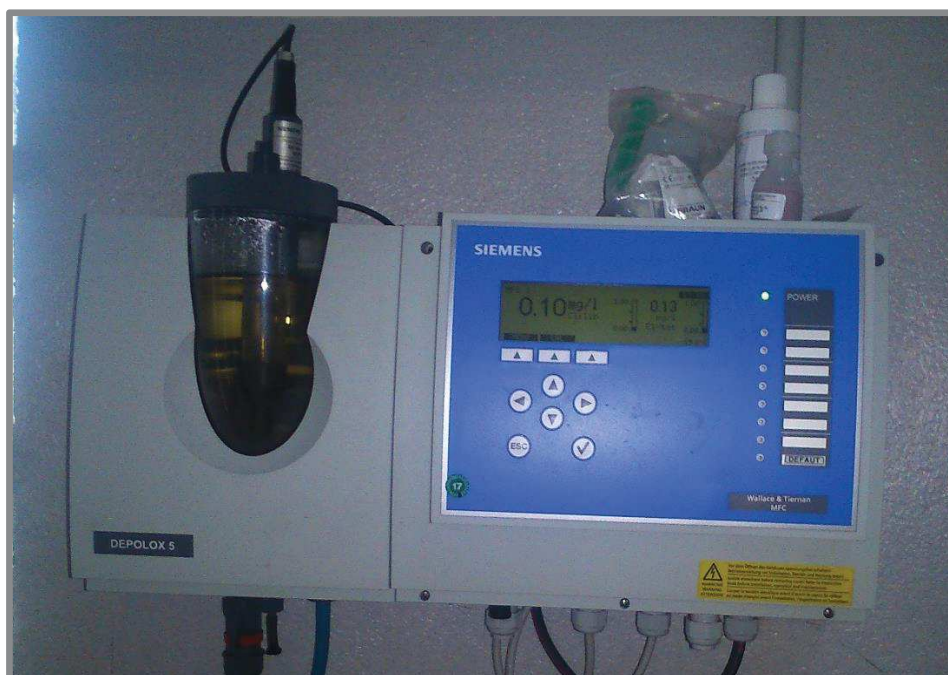
Figure 24 : Contrôleur multi-fonctions utilisé pour la mesure de chlore en continu
