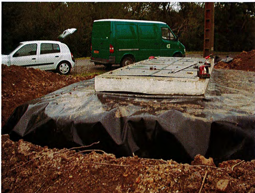
Figure 27 : Photographies des opérations de pose des géomembranes autour des forages F6S (en haut) et P3S (en bas)
