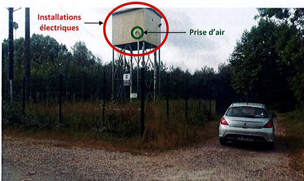
Figure 39 : Photographie des mesures de réduction prises pour faire face au risque d'inondation
