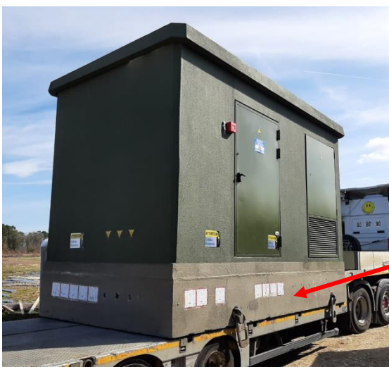
Bac de rétention d'un poste
