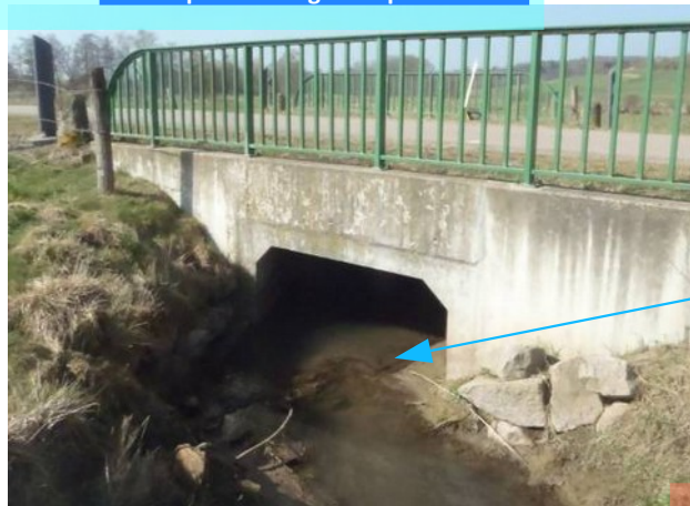
Exemple d'ouvrage mal positionné
