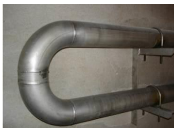
Figure 11 Serpentins de chauffage sur le digesteur et le post digesteur
