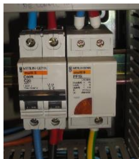
Photo n°2 : Parafoudre sur TGBT
