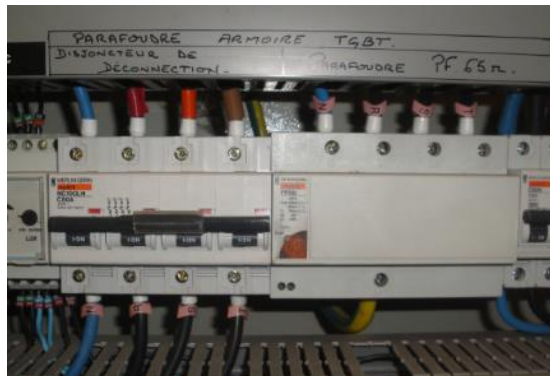
Photo n°1 : Parafoudre sur TGBT
