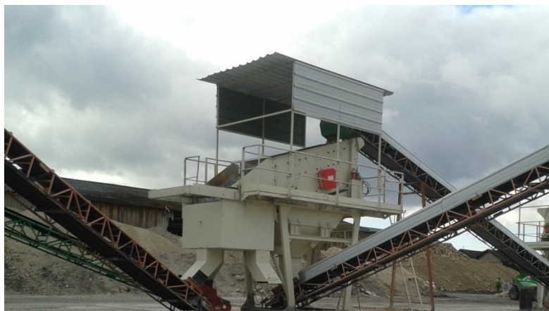
Figure 27 : Couverture des différents éléments de la station de concassage
