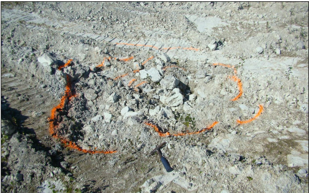
Figure 76 : Fontis en cours de formation dans la partie Sud du site de SOCODAC [Source : IMS RN ]
