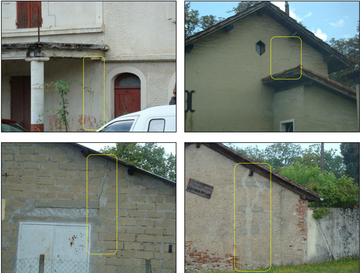
Figure 70 : Présence de désordres sur le bâti en périphérie de la zone fortement impactée [Source : IMS RN ]
