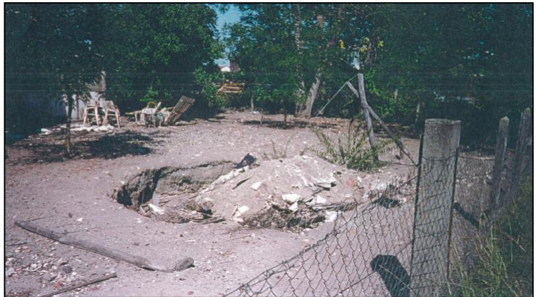
Figure 28 : Fontis en partie remblayé à l'angle du chemin de Cousseillat et de la RD 932 [Source : ANTEA]
