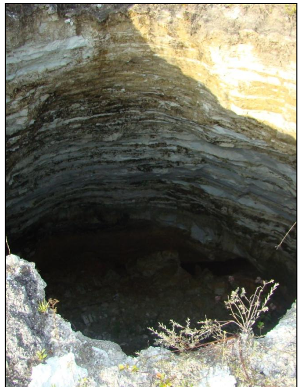
Figure 61 : Fontis d'environ 8 m de diamètre (désordre n° 6 dans l'étude BRGM) présentant un dévers marqué [Source : IMS RN ]
