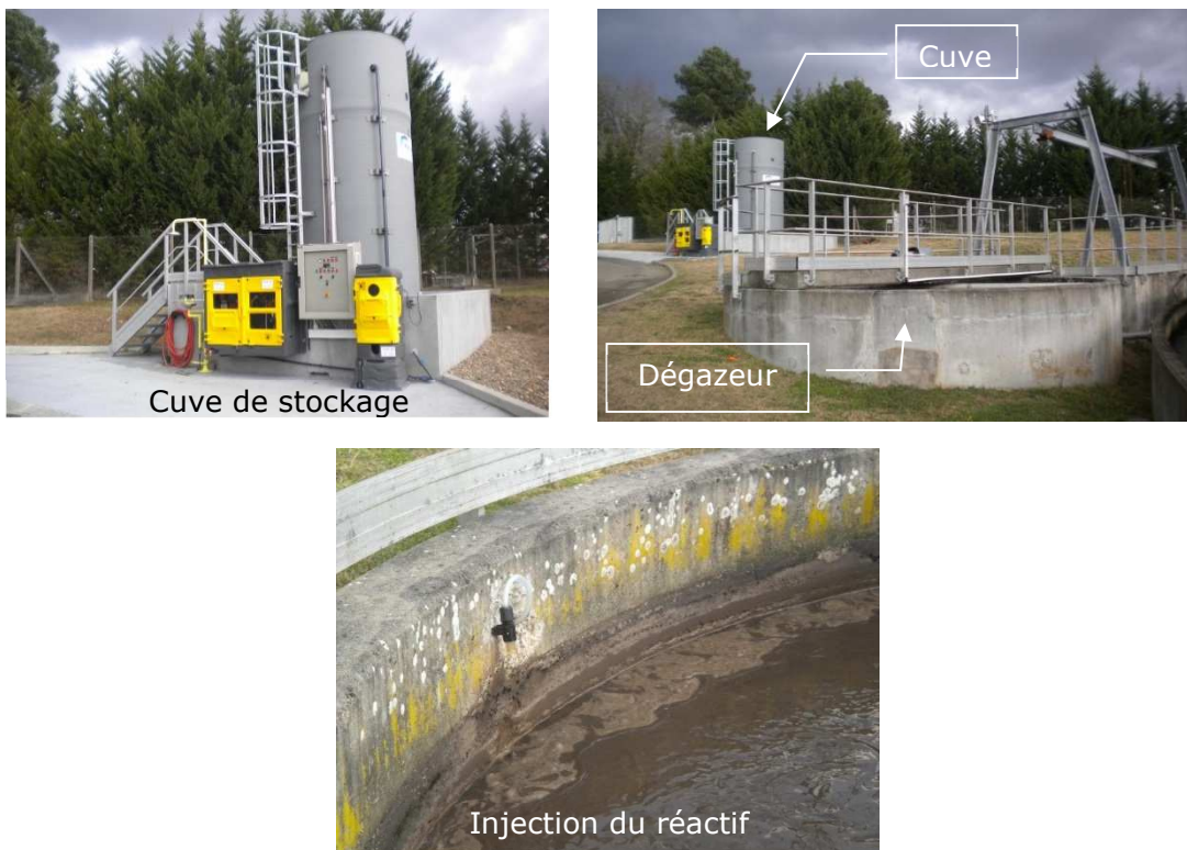
Figure 1 : Unité d'injection - Traitement physico-chimique du phosphore
