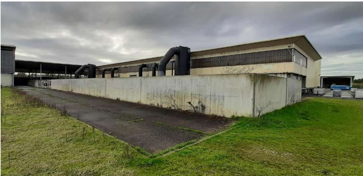
Figure 13 : Les deux tours de lavage de l'unité de désodorisation de l'usine de compostage de Thalie
