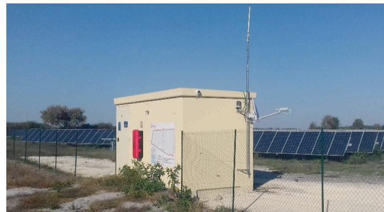
Photo 2 : Extincteurs CO 2 au niveau d'un poste de transformation
